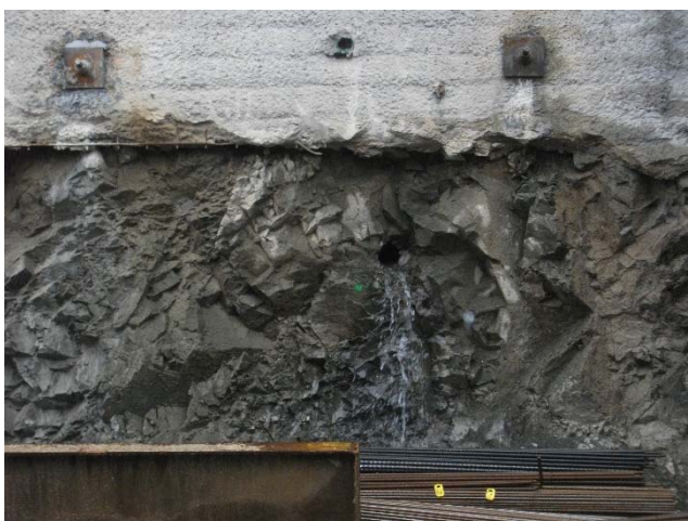
Fronte nord-est: fuoriuscita di acqua dal nuovo drenaggio
