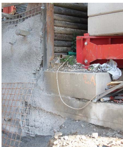
Dettaglio fessura parete nord
