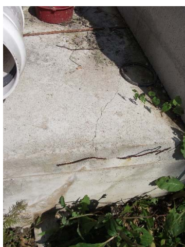
Dettaglio fessura basamento gru
